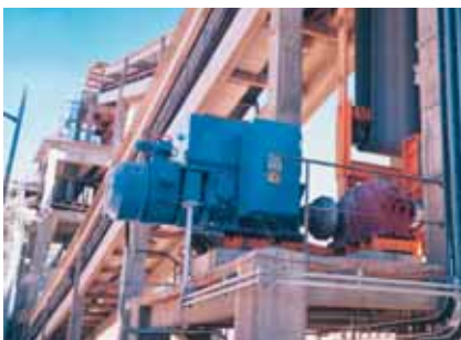
Suministro: MAF400, 331kW (440HP), 6.600V, 6 polos Aplicación: Cinta transportadora
