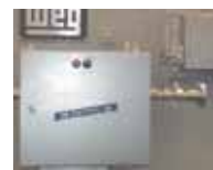
Sistema de presurización para área clasificada
