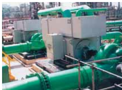
Suministro: MGF630, 1.070kW (1430HP), 13.200V, 8 polos Aplicación: Bombas
