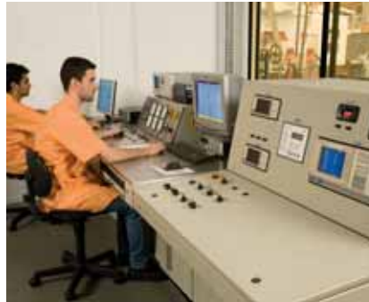
Sala de comando
