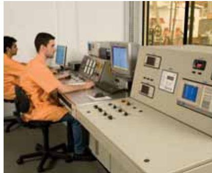
Sala de comando
