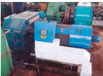
Suministro: HGF450, 1.170kW (1570HP), 480V, 6 polos Aplicación: Accionamiento de mollienda
