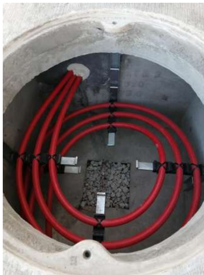
Figura 4. Tanquilla de un sistema subterráneo
