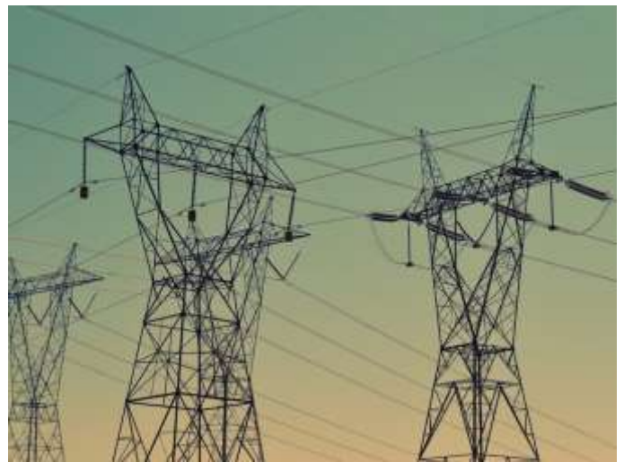
Figura 1. Líneas de transmisión
