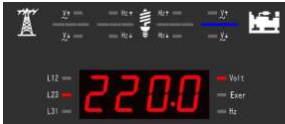
EX. Calibración de la fase de fuente de emergencia L23 Figura 22
